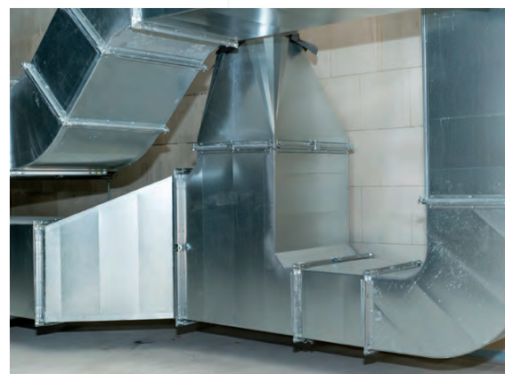
Verzinkte Blechkanäle führen die Lüftungsleitungen vom Keller über einen Installationsschacht in die einzelnen Geschosse.
